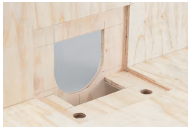
①木下地をあらかじめ加工しておきます。 下図 耐水合板・下地材加工寸法表参照
